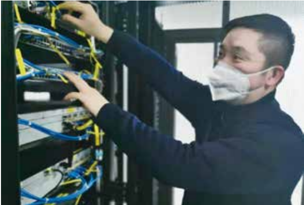
湖北凯亚员工在武汉机场机房检查设备
