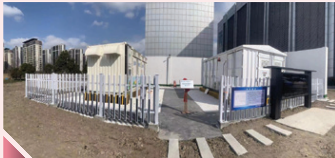
数据中心侧储能系统
